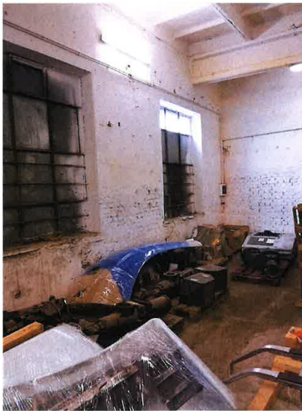
Zdjęcie nr 2 – aktualny stan posadzki
