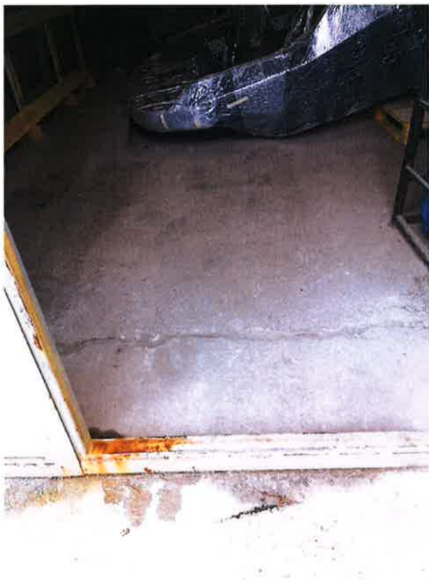
Zdjęcie nr 1 – aktualny stan posadzki
