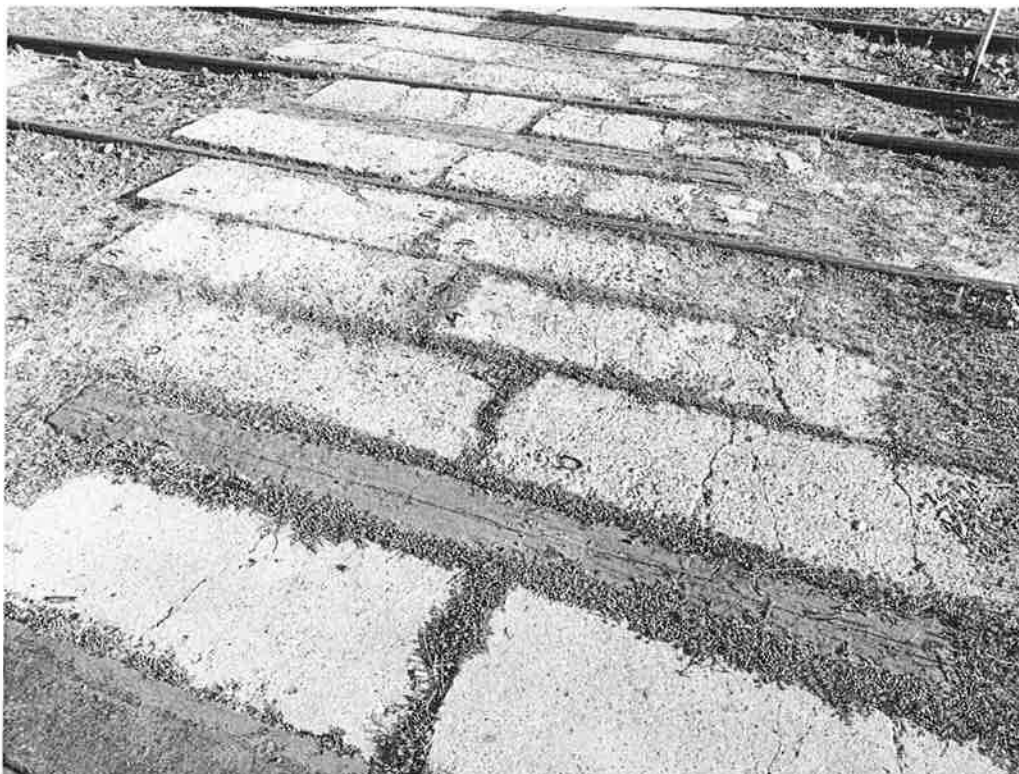
Zdj. 6 Nawierzchnia drogi dojścia pomiędzy torem 202-203
